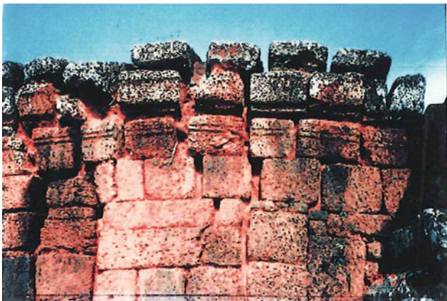
写真-5 ラテライト塼の緩み
