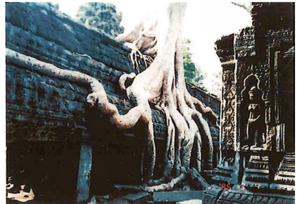
写真-3 樹木による建物の破壊
