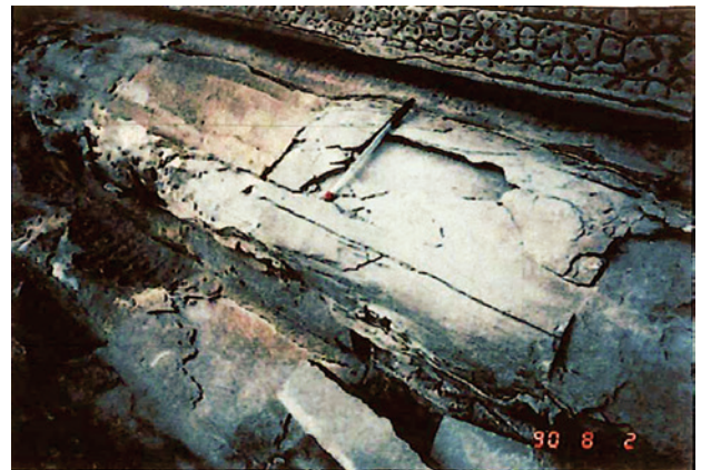
写真-8 砂岩の剥離
