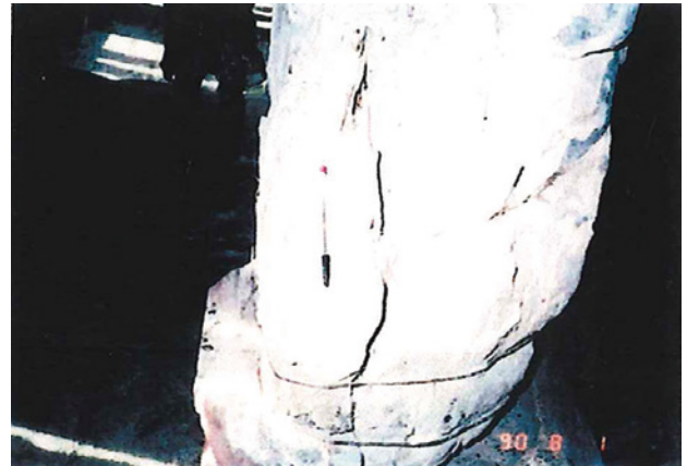
写真-9 石柱の亀裂とクラック
