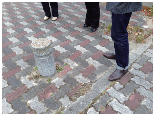
図2. 歩道のタイルの段差
